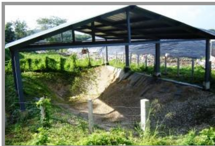
Foto 4. Celda de Seguridad en Relleno Sanitario "Magic Garden"
